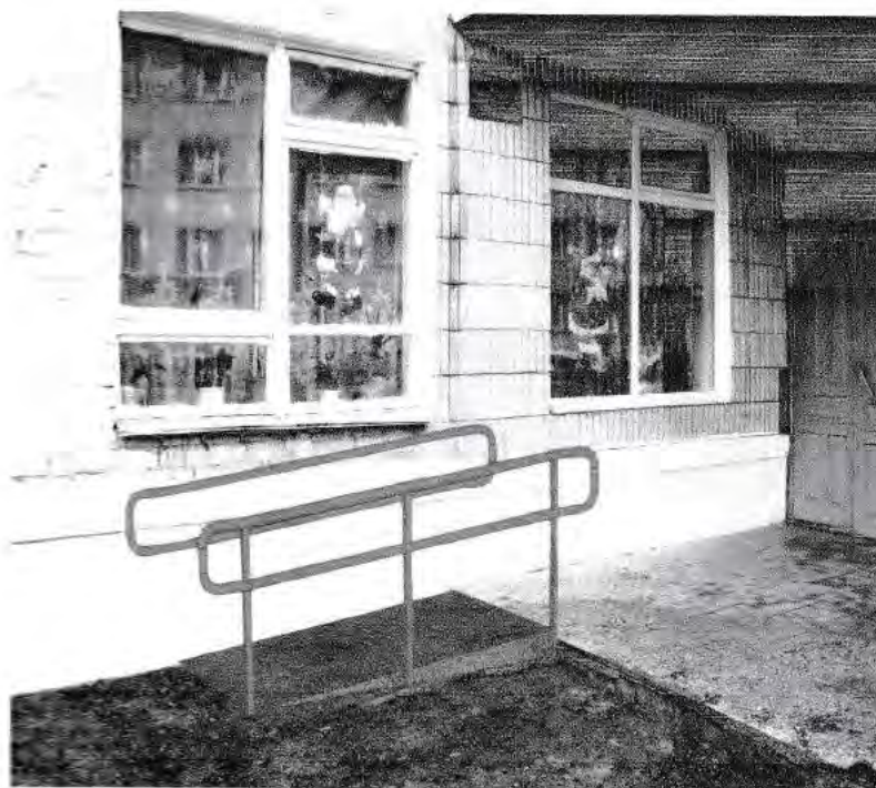
Загальний вигляд пандусу
