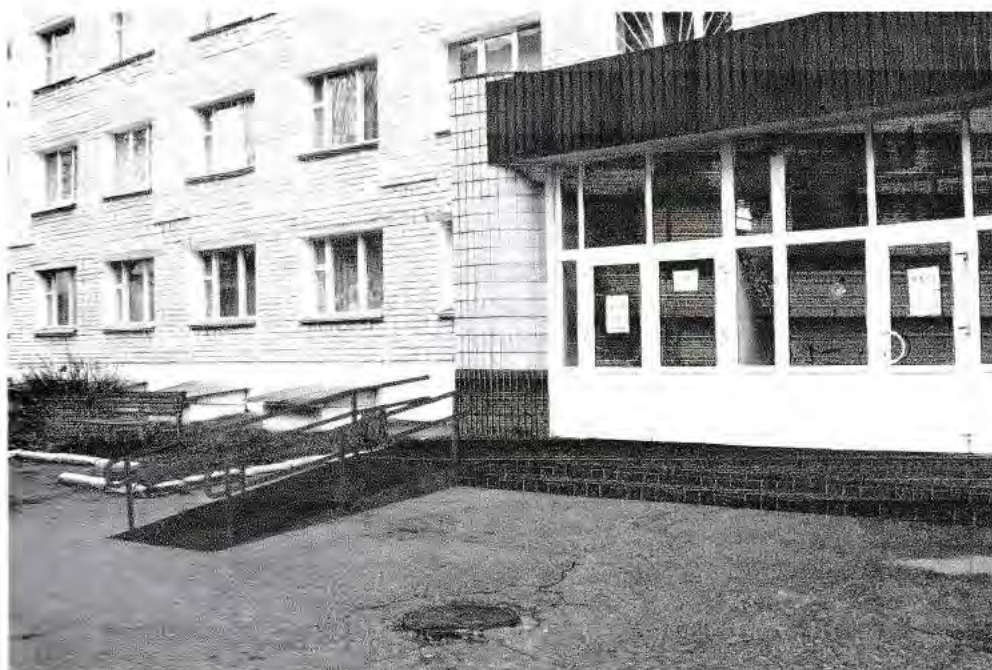
Загальний вигляд пандусу
