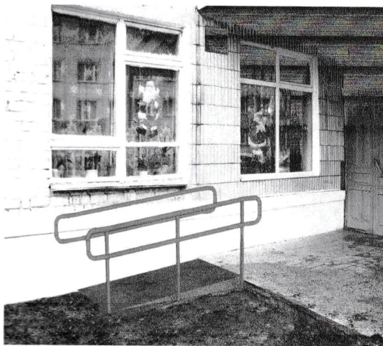
Загальний вигляд пандусу
